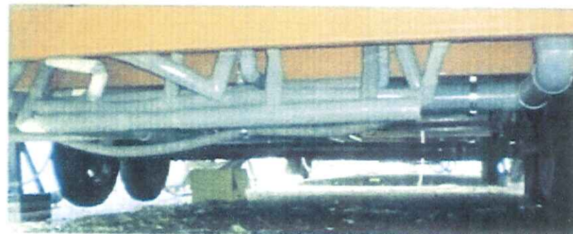
トレーラーハウスの給水・配水管は一括してまとまっております。
